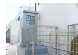
排水ポンプ場
